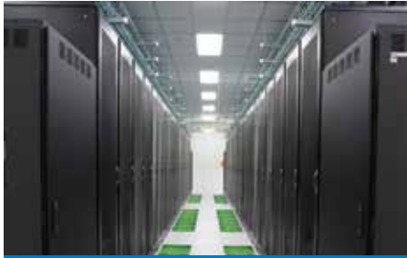
Infraestructura de TI (racks de alta densidad)
